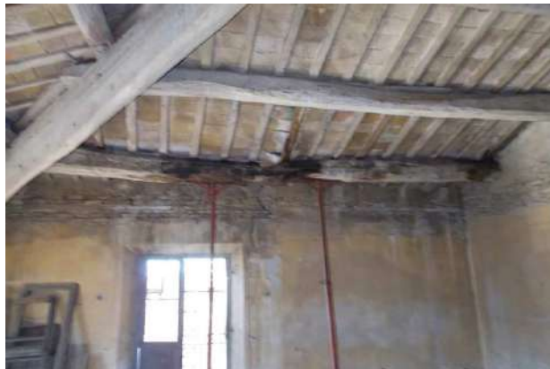
Fatiscenza di alcune parti strutturali dell'edificio
